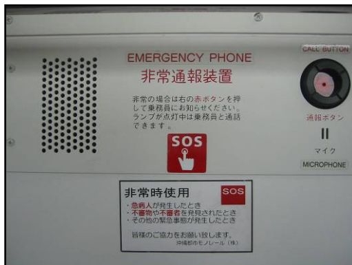
(車椅子スペース側 非常通報装置)
